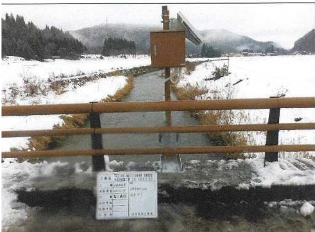
内川 能代市二ツ井町小掛(鬼っ子橋) 【超音波式水位計】
